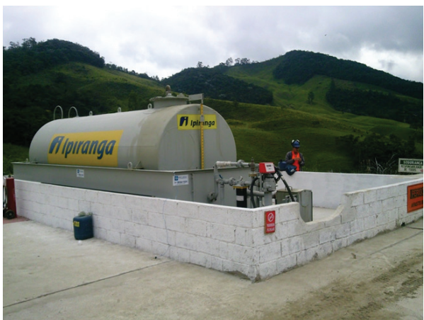
Bacia de contenção para ponto aéreo de combustível. Obra da BR 116, Manhuaçu/MG, EGESA Engenharia S/A.
