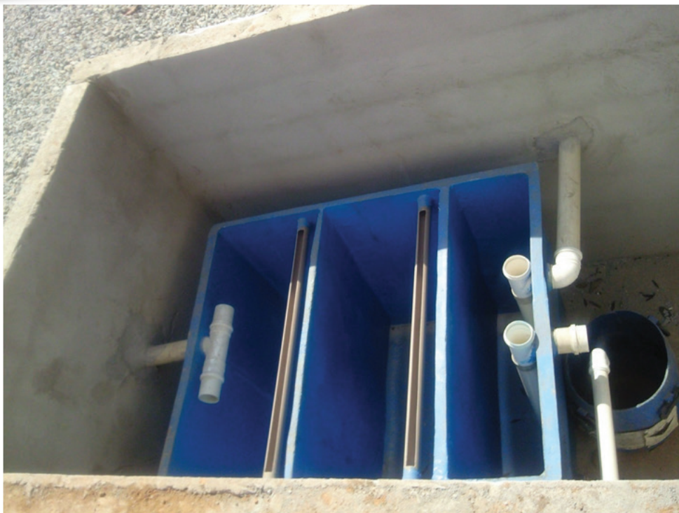
Caixa Separadora de Água e Óleo (SAO). Obra da BR 262/MG - Pará de Minas. EGESA Engenharia S/A.
