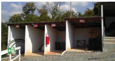
Baias de Resíduos em Alvenaria. Obra da BR 262/MG, Pará de Minas, EGESA Engenharia S/A.
